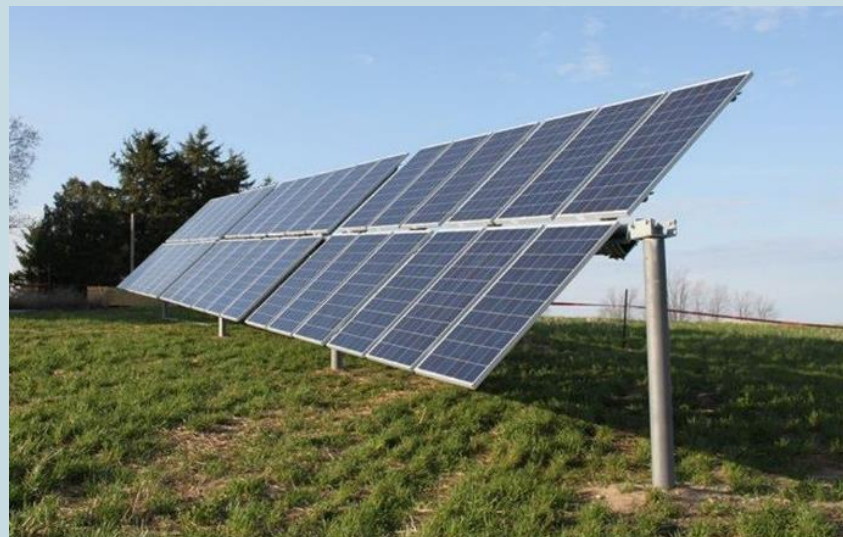
Foto 1: Solceller monteret på stativer med tracker system
