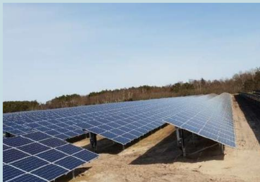
Foto 2: Solceller monteret på faste stativer
